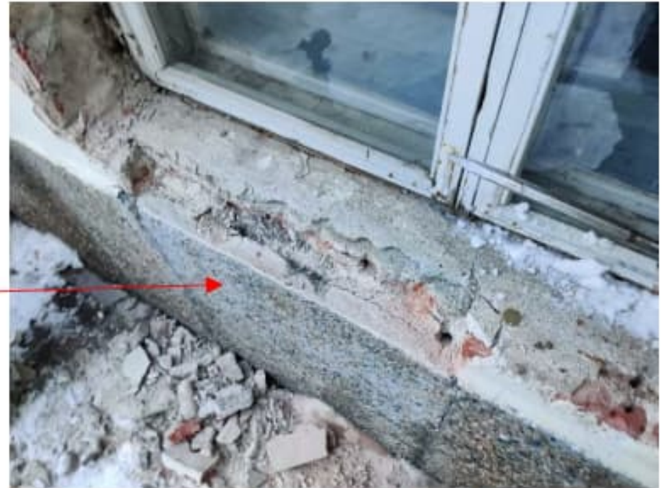
Kuva 63. Laatan paksuus vaihtelee havaintojen perusteella 40...100 mm välillä.
