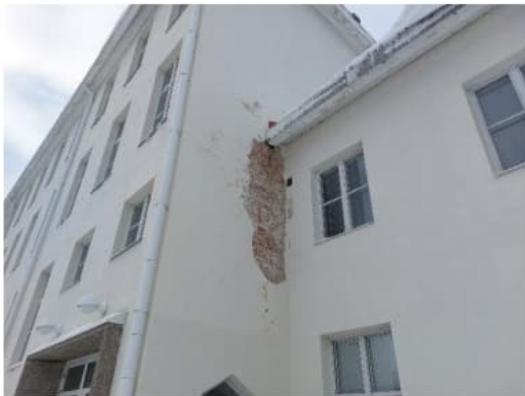
Kuva 81. Ulkoseinässä on paikoin havaittavissa sadevesien aiheuttamaa rapaumaa.
