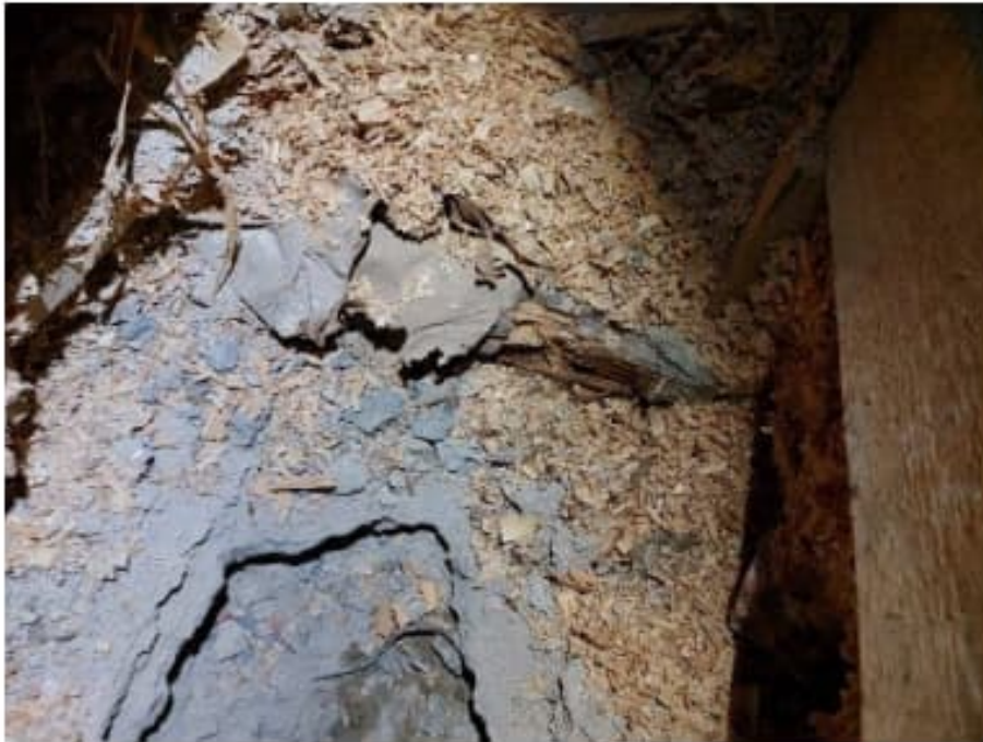
Kuva 20. Lattiarakenne on kannatettu maakosteaan betonia vasten olevien lankkujen varaan. Lankut todettiin lahonneeksi. AP4.
