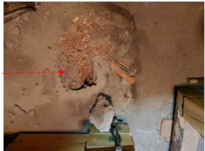
Kuva 99. Avauskohdasta aistittiin mikrobiperäistä hajua eristeestä sekä laudoituksesta.
