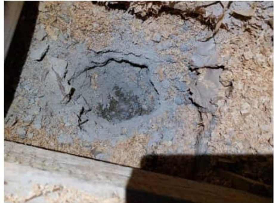
Kuva 21. Eristeenä olevasta kutterinlastusta otetussa näytteessä todettiin selvää mikrobikasvua materiaalissa. Betonin alla oleva hiekka oli tutkimushetkellä märkää. AP4.
