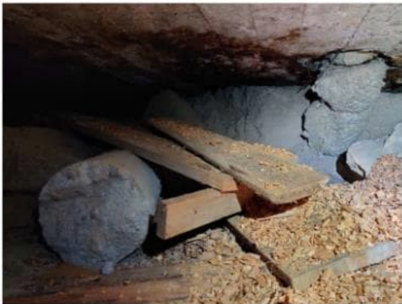
Kuva 12. Paikoin alapohjan eristeet ovat valuneet tilaan.
