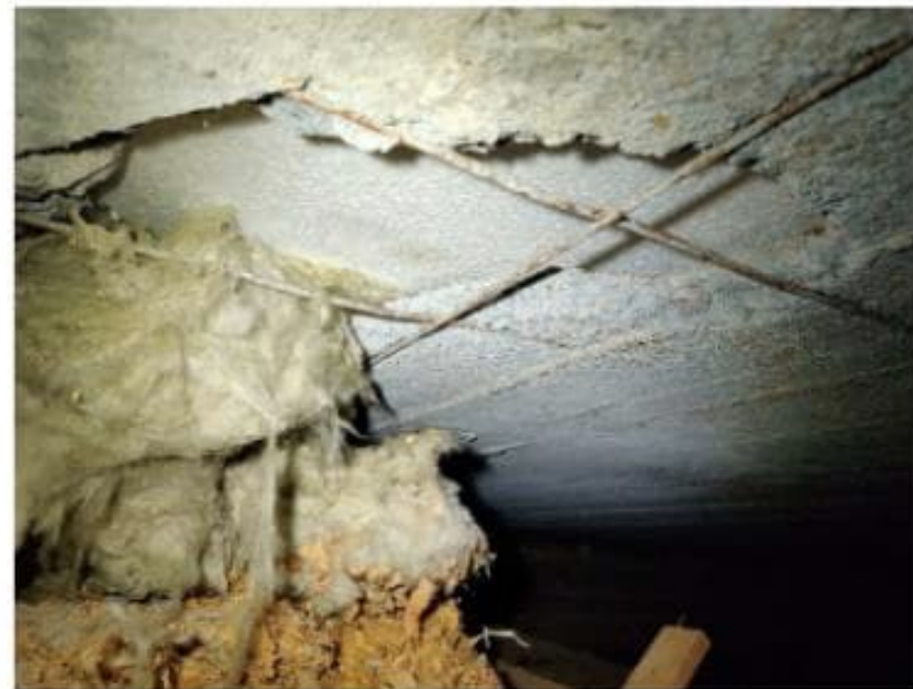
Kuva 13. Pohjalaatta on paikoin rikki. Sen paksuus vaihtelee muutamasta millistä useaan senttiin.
