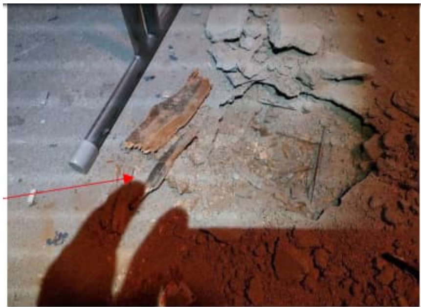
Kuva 97. Avauskohta PP1 tehtiin tilan keskivaiheille. Puusta otetussa näytteessä todettiin selvää mikrobikasvua materiaalissa.
