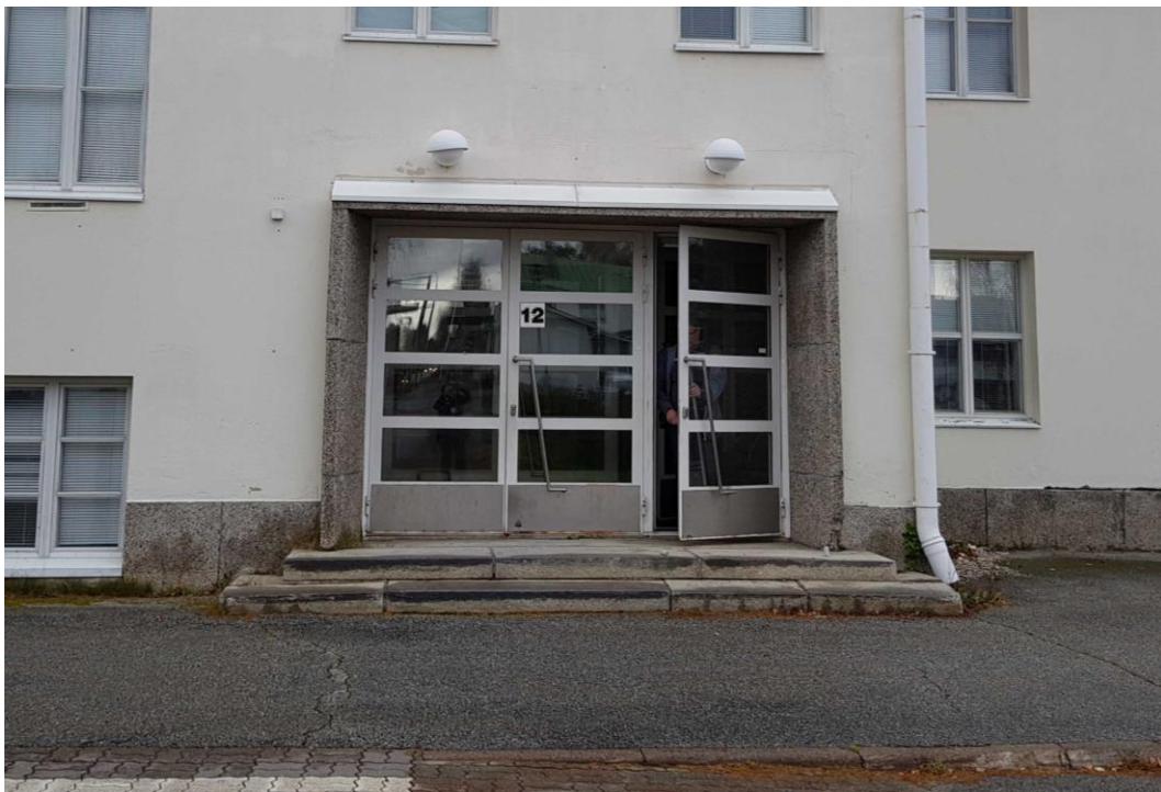
Pääsisäänkäynti. Portaat ja sisäänkäyntiä ympäröivät kehykset ovat alkuperäiset. Nykyiset ulko-ovet ovat peräisin todennäköisesti vuoden 1990 peruskorjauksesta. Samaa aikakautta edustavat sisäänkäynnin päällä olevat valaisimet. Myös sisäänkäyntiä ympäröivän kehyksien päällä oleva pellitys lienee peräisin peruskorjauksesta.
