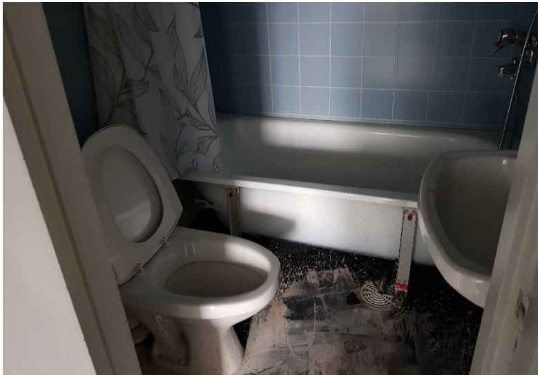
Kylpyhuone. Sotku lattialla on peräisin rakennusvaurioiden poistamisesta.
