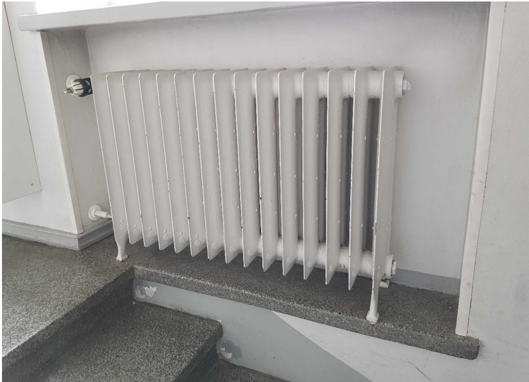
Patterit ovat koko rakennuksessa alkuperäiset.
