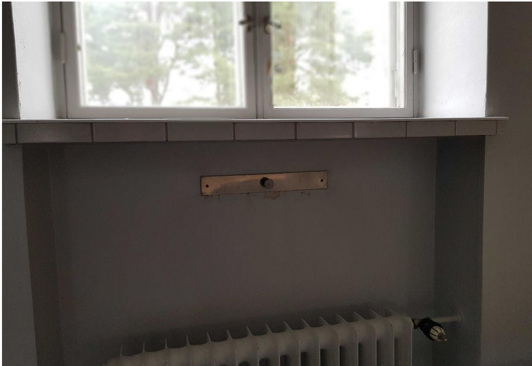
Salin ikkunoiden alapuolella on säädettävät tuuletusventtiilit.
