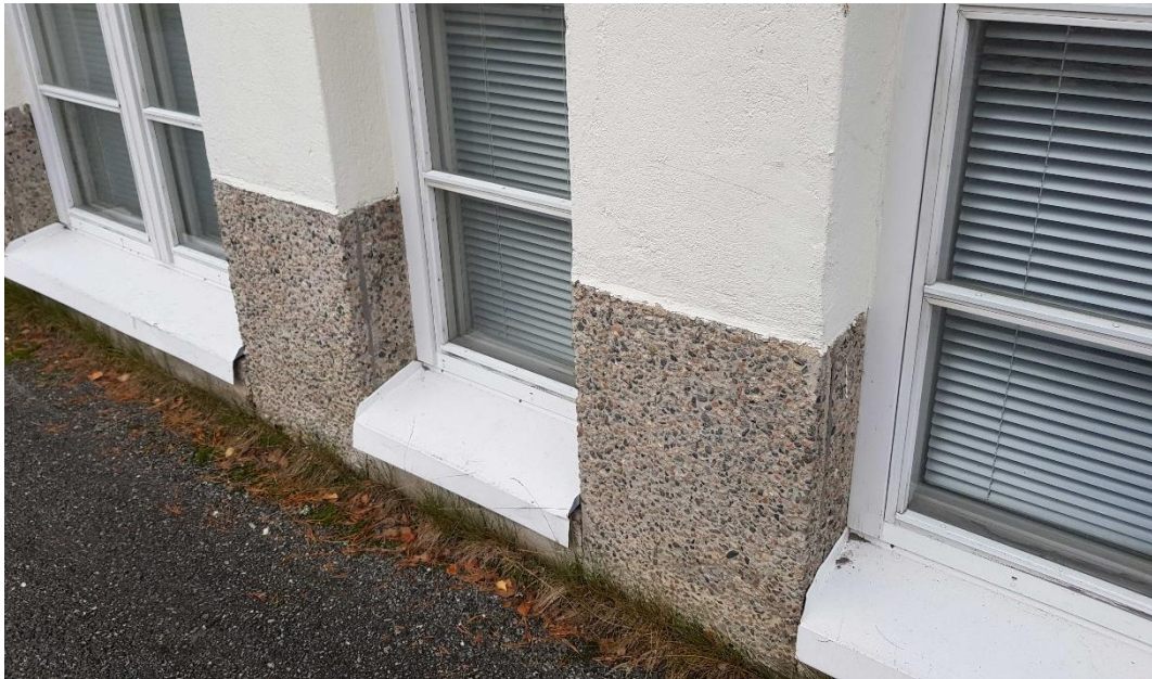
Kivijalan pintamateriaalina ovat pesubetonilaatat. Alkuperäisiin suunnitelmiin kuuluvan rakennusselityksen mukaan. "Sokkeli tehdään pesubetonilaatoista. ... Saumaus suoritetaan laattojen värisellä mutta hiukan tummammalla laastilla." 57
