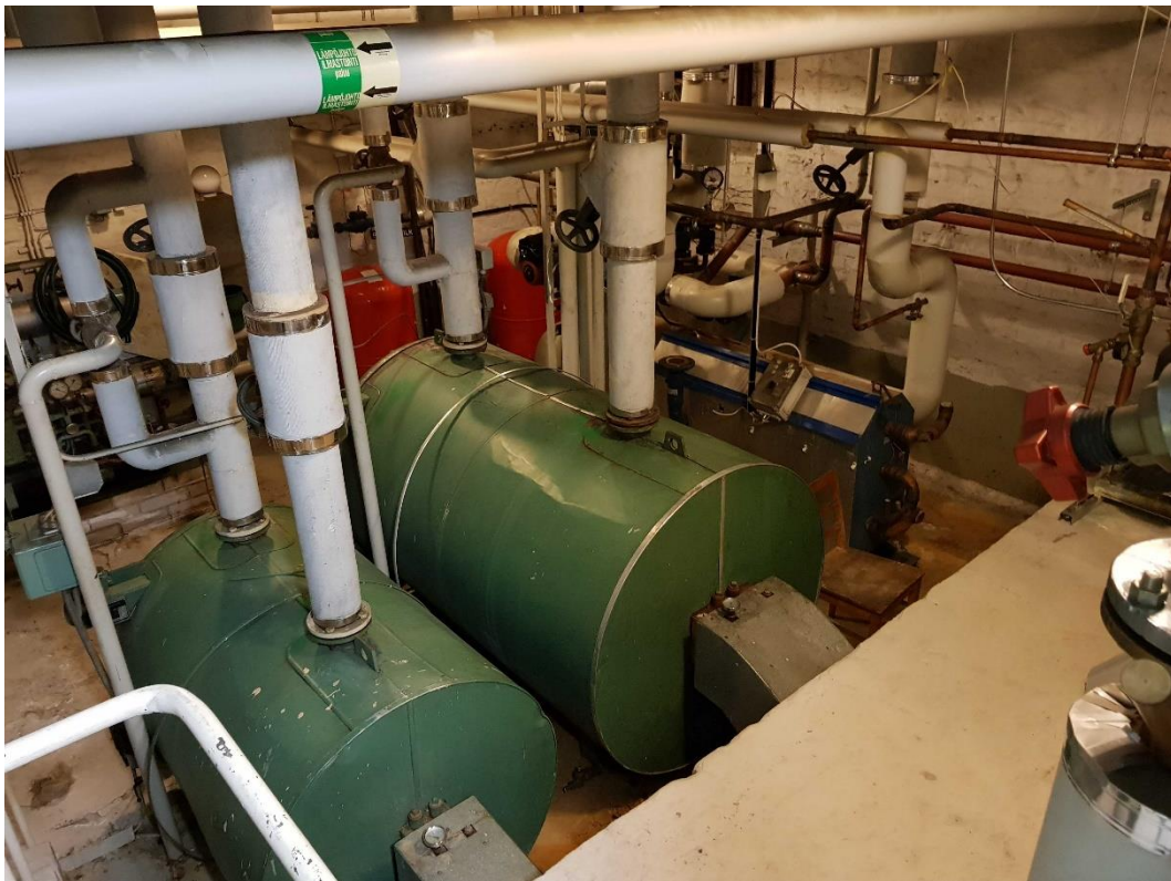
Lämmönjakuhuone sijaitsee alkuperäisellä paikallaan kellarissa.
