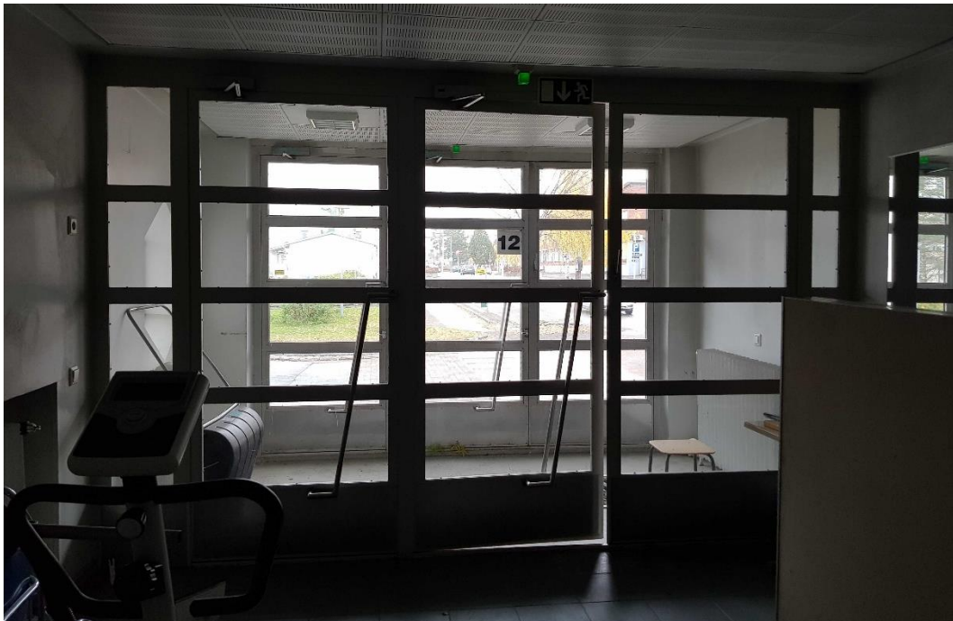
Koulurakennuksen pääsisäänkäynti sijaitsee rakennuksen kaakkoisivulla Kontionkadun varressa. Rakennukseen kuljetaan leveiden teräsrunkoisten lasiovien kautta. Ovet on uusittu, todennäköisesti vuonna 1990 toteutun peruskorjauksen yhteydessä.
