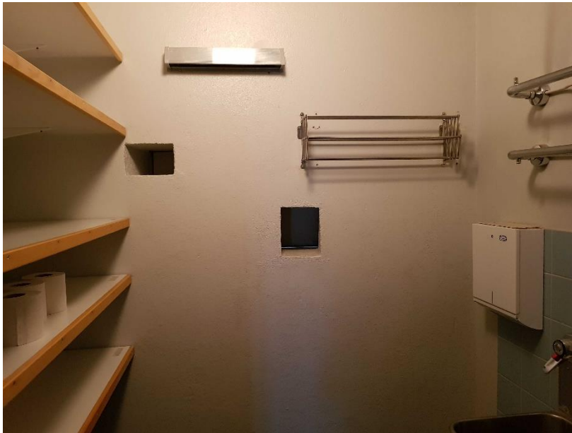
Aukot sijaitsivat nykyään siivouskomerona toimivassa tilassa. Alkuperäisissä piirustuksissa sen paikalla on porrastasanteelle avautuva pieni huone/komero, jota ei ole nimetty. Aukkojen käyttötarkoitus ei ilmene piirustuksista. Aukot on voitu alun perin tehdä elokuvaprojektorin varten. Kenties salin alun perin tasaiseksi ratulle takaseinälle on aikoinaan heijastettu elokuvia.
